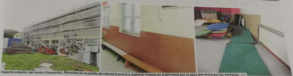
Aspecto exterior del centro (izquierda), filtración en el pasillo de infantil (centro) y material mojado en el gimnasio por el agua que entra por las ventanas. AMA
